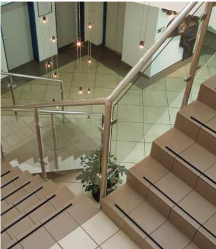
Stufenkante deutlich sichtbar – „Griffiger“ Handlauf
